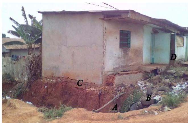
Photo 3 : bâti mise en péril par les eaux de ruissellement
