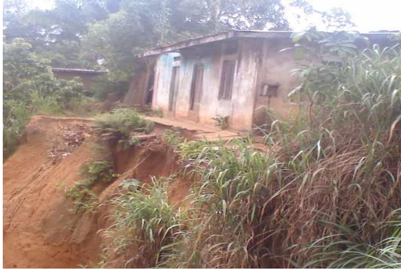
Photo N°13 : Un éboulement au quartier Bronoukro
