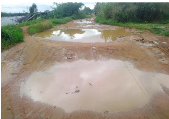
Photo N°6 : La stagnation de l'eau pluviale sur une voie en terre au quartier Koumassi
