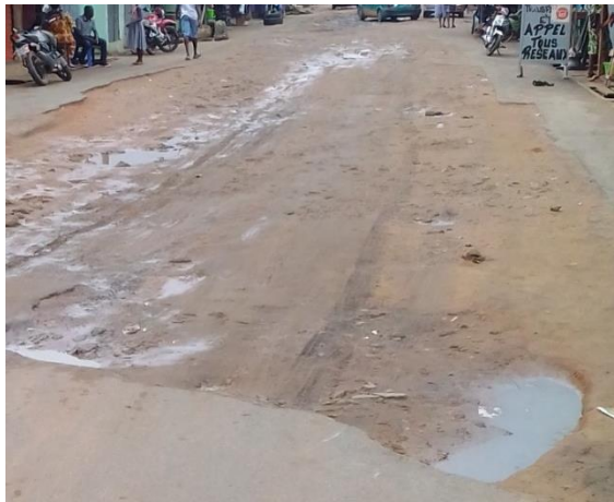
Photo N°4 : Une voie bitumée dégradée au quartier Koumassi
