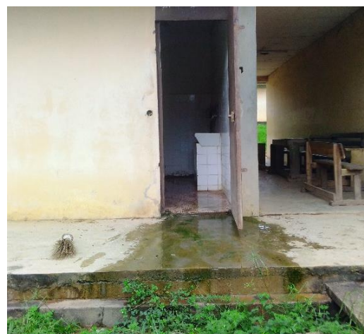
Photo N°2 : Des toilettes non fonctionnels administratif du lycée moderne
