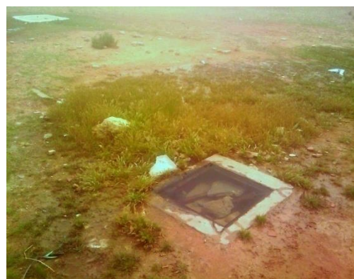
Photo 4: la saturation du regard
