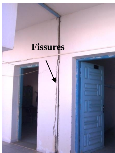
Photo 7: Ouverture du joint de rupture n°1 avec la présence de plusieurs fissures
