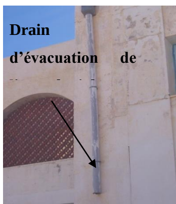
Photo 5: Un tuyau de drainage de l'eau de pluie
