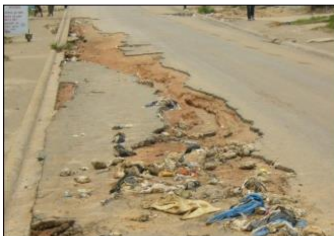
Photo a : Une voie dégradée
